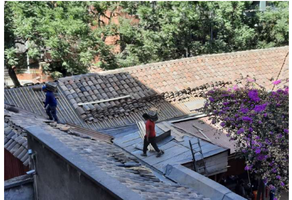
Figura 17: Fotografía trabajos de restauración en techumbre de la primera crujía casa Santo Domingo, 2022.
